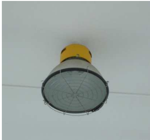
Figura 4: Apparecchi di illuminazione esistenti a vapori di mercurio ad alta pressione
